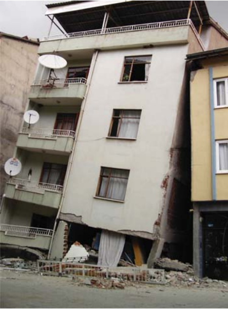
Şekil 2 - Zemin katı tamamen yıkılmış bina- dan bir görünüm
