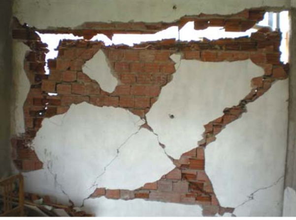
Şekil 1 - Dolgu duvar hasarlarından bir görünüm
