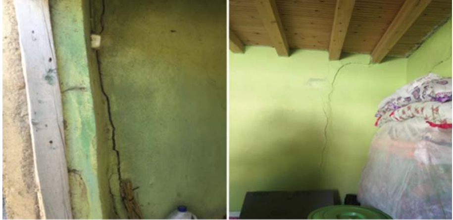
Şekil 14 - Duvar bağlantısı hasarları
