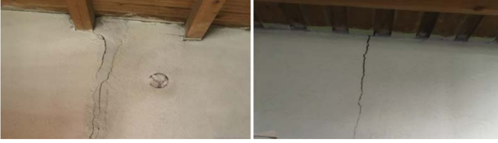
Şekil 15 - Duvarlarda gözlemlenen hasarlar
