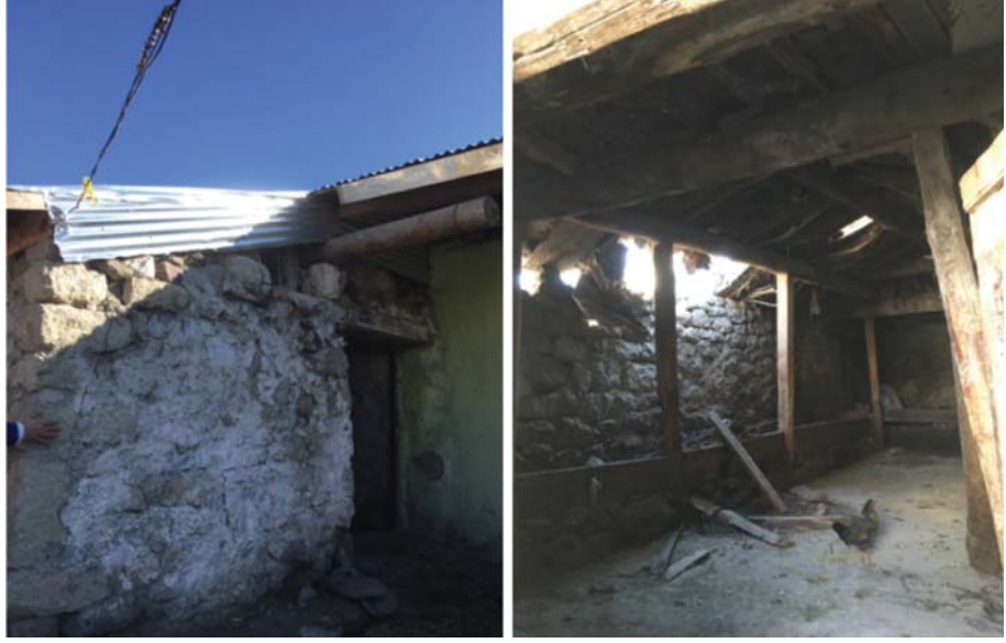
Şekil 13 - Çatı ve döşeme bağlantısı hasarları
