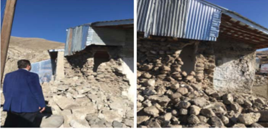
Şekil 11 - Bağlayıcı derzlerin bırakılmamasından dolayı oluşan kesme hasarları
