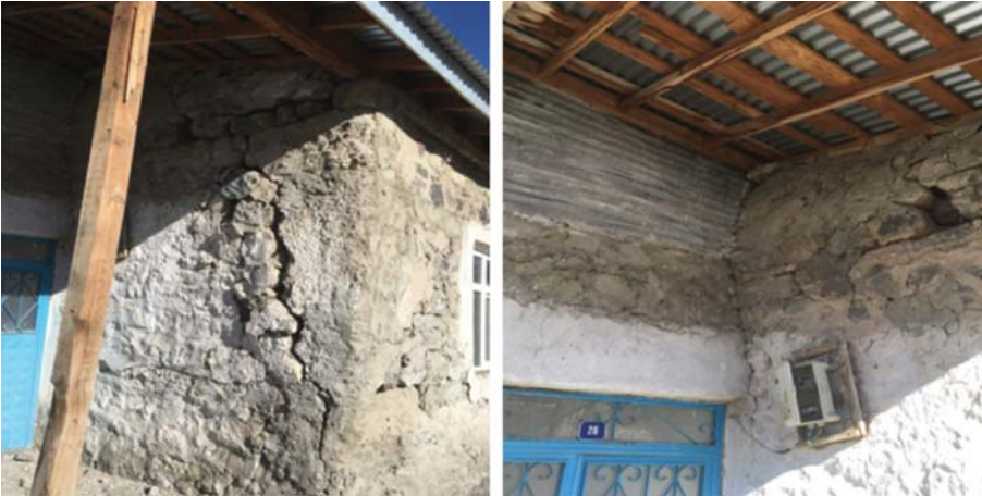
Şekil 12 - Çatı ile yağma duvar bağlantısı hasarları
